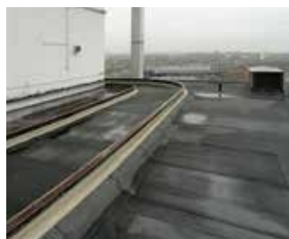
Łączenia między szynami konserwacyjnymi na dachu i pasmami bitumicznymi...
