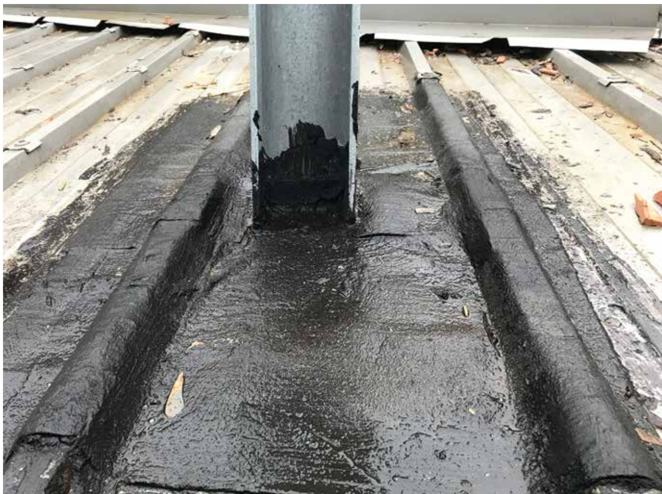
Przeciekające, tradycyjne uszczelnienie detalu w kształcie profilu „H” z papy bitumicznej
