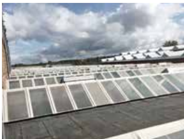
Sheddach Industriehalle, Braunschweig (DE) • Besonderheit: Glasabdeckung • Objektgröße: 4.000 m • System: Triflex ProDetail • Fertigstellung: 2016
