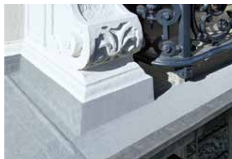
Jahrhunderte alte Details werden mit dem modernen Abdichtungssystem Triflex BTS-P für die Zukunft bewahrt. Auf engstem Raum und in verwinkelten Ecken entfaltet der Flüssigkunststoff seine Vorteile.
