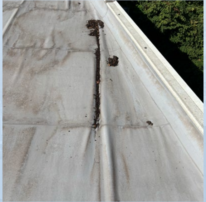
Faltenbildung in den Bereichen des Wandanschlusses
